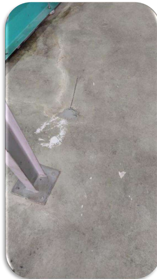
Bloqueio de saídas de contaminantes para a rede pluvial - Subestações
