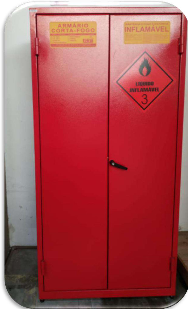
Adquirido armário de inflamáveis para o setor do almoxarifado.
