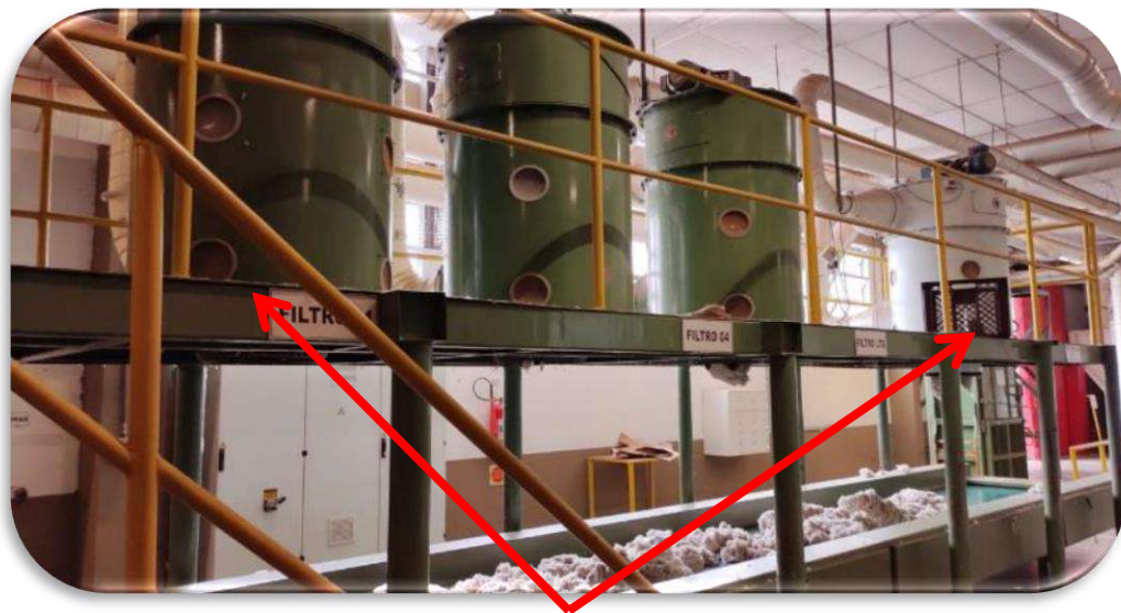
Antes - Ausência de rodapé.
