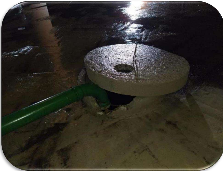
Antes - Tampa quebrada.
